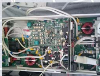
接続箱・断路器部の焼損
